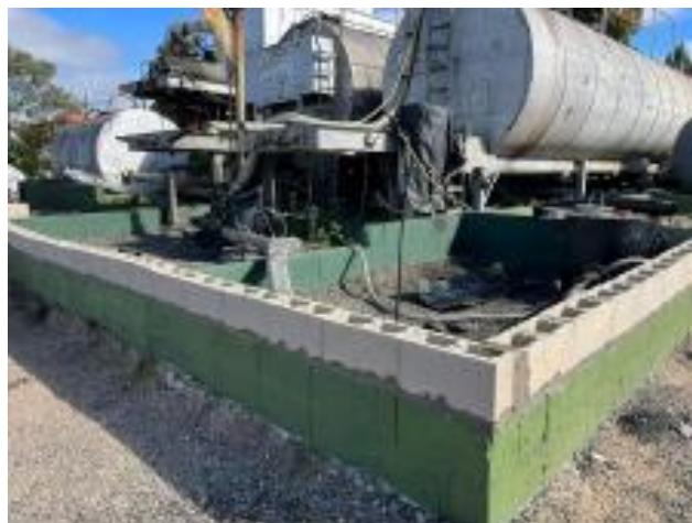
Foto 12.3-2, Obrador central de CVC SA. Se elevó la altura del envallado perimetral de las cisternas de asfalto, de modo de alcanzar el 110% del volumen de un eventual derrame.
