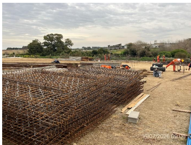
Foto 12.2-8, P05. Obrador. Explanada de acopio de armadura. Falta infraestructura para el acopio temporal de residuos segregados en origen.
