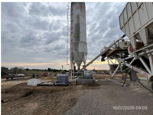
Foto 12.2-5, P05. Planta de hormigón, los productos químicos están en un recinto con capacidad envallada inferior al 110% del volumen almacenado.
