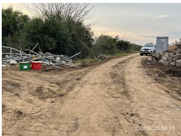
Foto 12.1-5, P01. Se instaló infraestructura para el acopio temporal de residuos segregados en origen.
