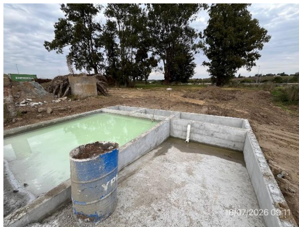
Foto 12.2-4, P05. Planta de hormigón, pileta de lavado de camiones mixer.
