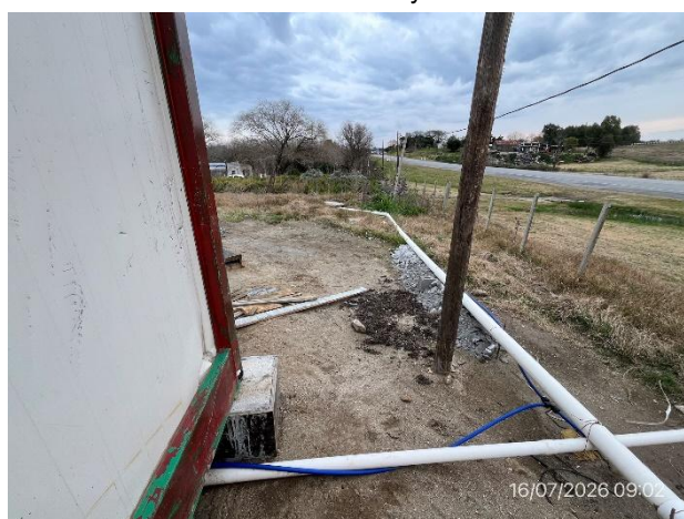
Foto 12.2-12, P05. Desagües de aguas servidas, son conducidas a un depósito impermeable.
