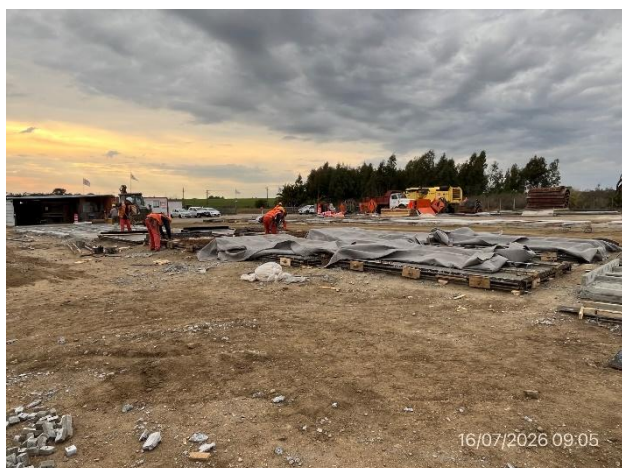
Foto 12.2-7, P05. Obrador, sector de prefabricados de hormigón. Falta infraestructura para el acopio temporal de residuos segregados en origen.
