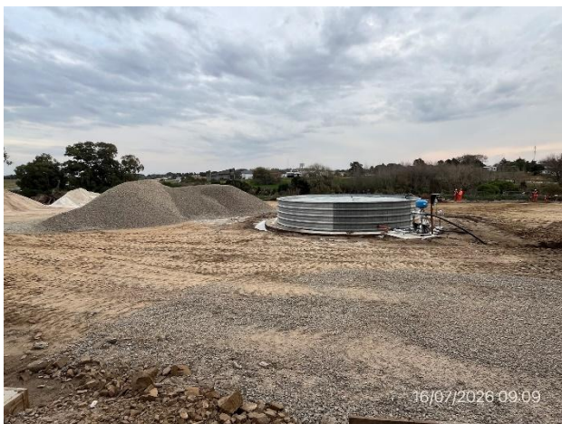
Foto 12.2-3, P05. Planta de hormigón, tanque australiano y explanada de acopio de áridos.
