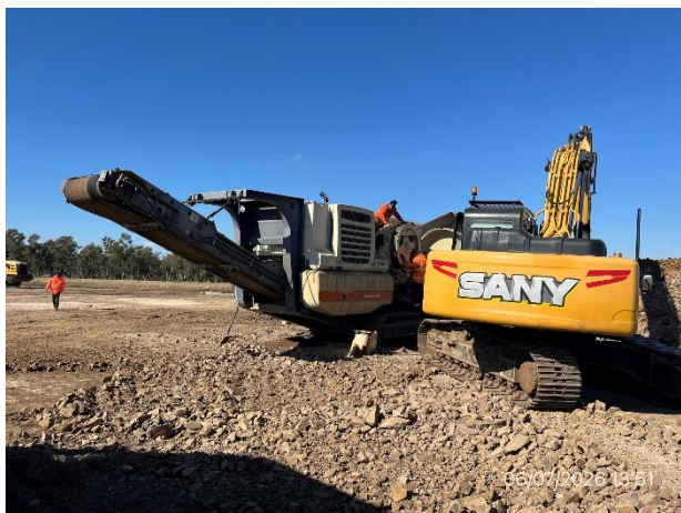
Foto 12.1-9, P06. Reparación de maquinaria fuera del sector de taller mecánico, con procedimiento en ejecución que no está apegado al PGA.
