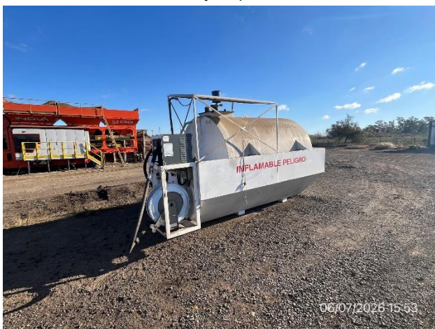
Foto 12.2-5, P04. Tanque de combustible alojado en recinto envallado.
