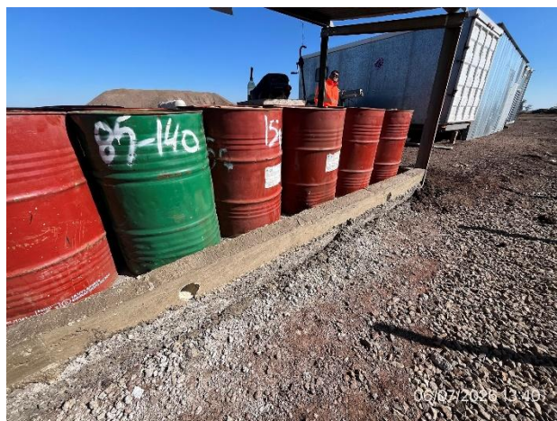
Foto 12.1-6, P03. Faltan cierres en los desagües del envallado perimetral de la explanada de tarrinas de aceite.
