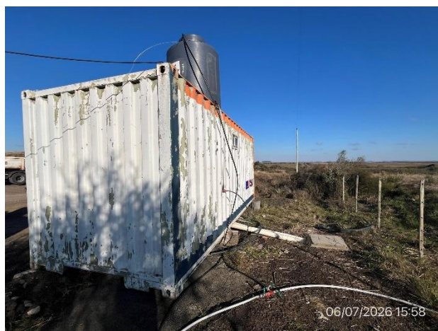
Foto 12.2-8, P04. Los servicios higiénicos desagotan a un pozo impermeable.
