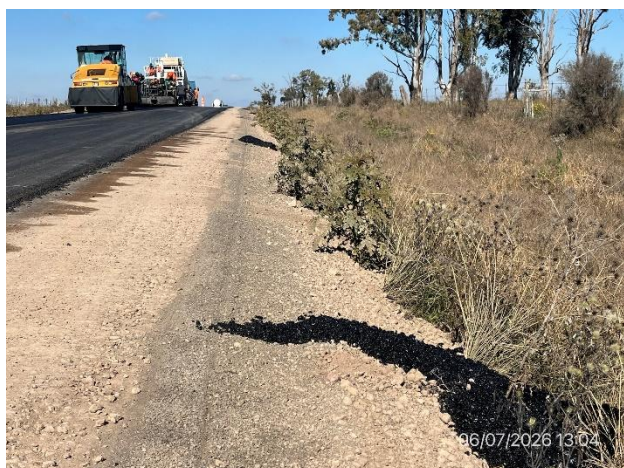
Foto 12.3-9, P05. A consecuencia del voleo de sobrantes de mezcla asfáltica, hay restos en la banquina que se extienden al suelo desnudo de la faja pública.
