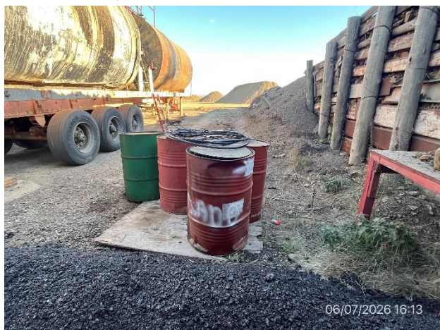
Foto 12.2-11, P04. Planta asfáltica, hay tarrinas de aceite fuera del recinto apropiado.
