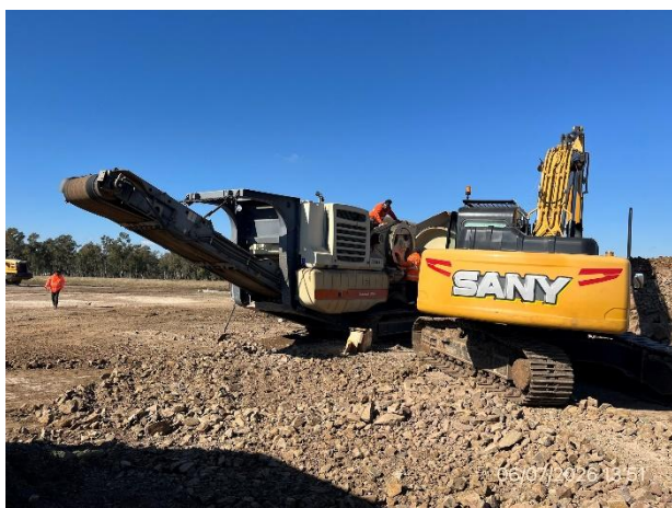
Foto 12.1-9, P03. Reparación de maquinaria fuera del sector de taller mecánico, con procedimiento en ejecución que no está apegado al PGA.
