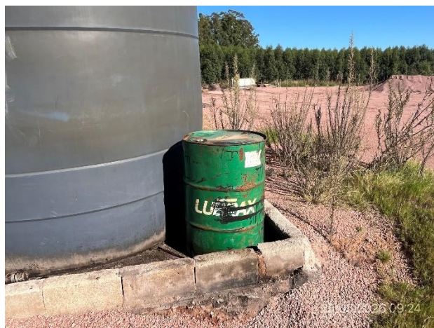
Foto 12.1-8, P03. Planta asfáltica sin actividad, el tanque de combustible está perforado y no alberga el 110% del volumen de combustible acopiado.
