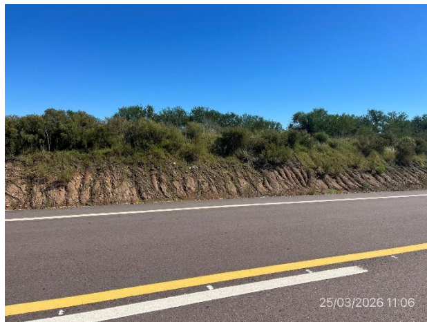
Foto 12.2-9, Ruta 6. Hay erosiones puntuales en los taludes de la faja pública
