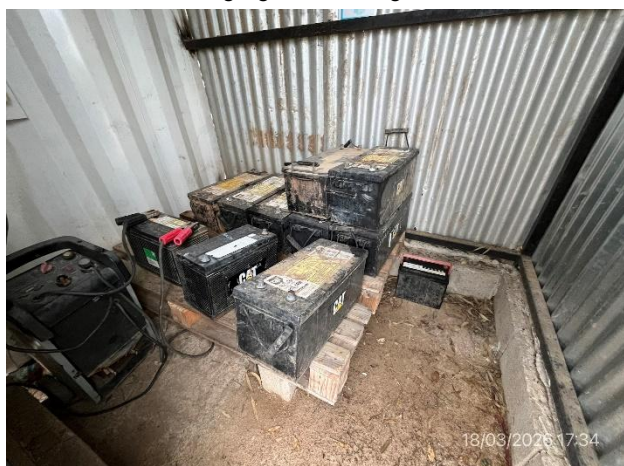
Foto 12.2-5, P03. Obrador, acopio de baterías usadas en local envallado y cerrado.
