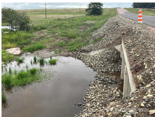
Foto 12.1-9, P06. El desagüe de la alcantarilla se encuentra parcialmente obstruido con material granular del terraplén
