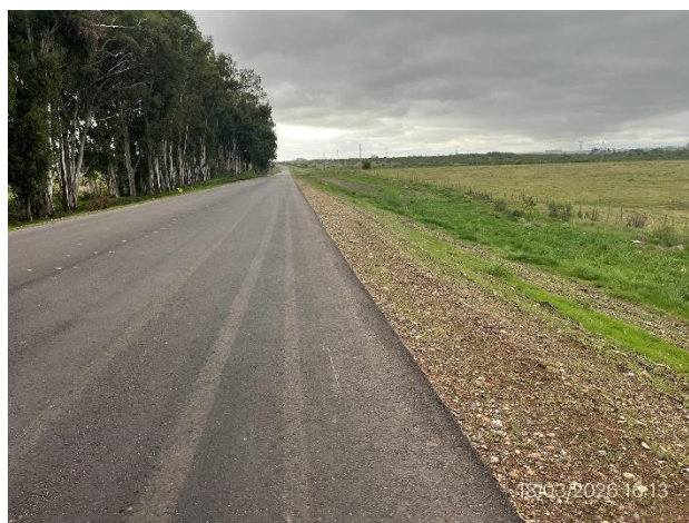
Foto 12.1-4, Ruta 26. Cunetas con drenaje correcto y empastado vegetal incipiente.
