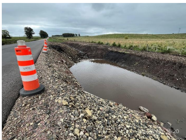
Foto 12.1-7, P07. Alcantarilla abierta al tránsito. Ruta 26 progresiva 413K000. Falta cobertura vegetal en los taludes.
