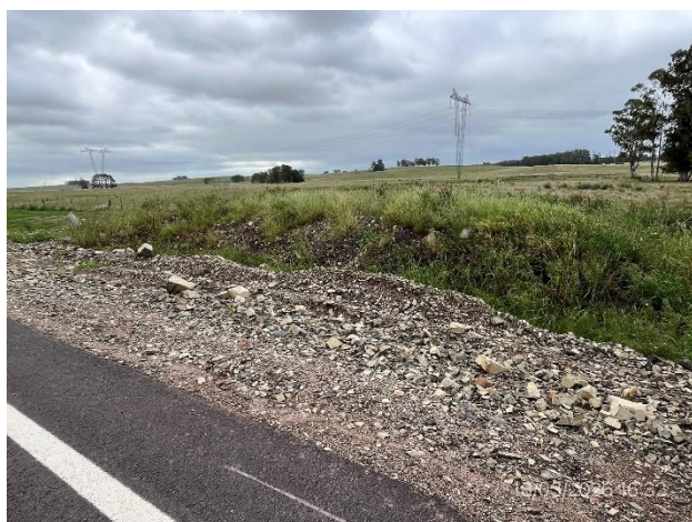
Foto 12.1-11, P05. En la senda a (-) hay materiales sobrantes de excavación de la alcantarilla que obstruyen la cuneta que desagua en ella.
