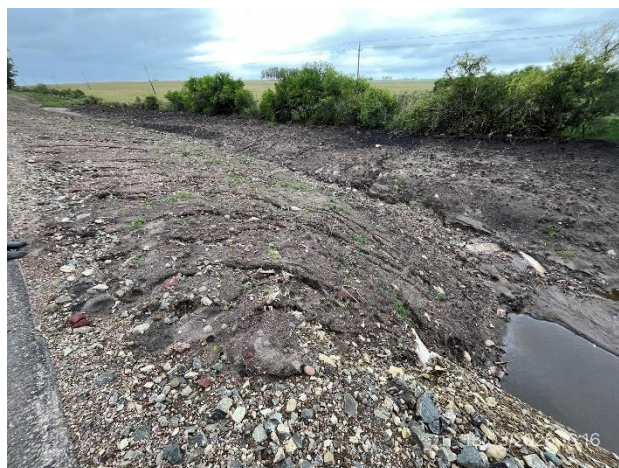
Foto 12.1-6, P08. Falta cobertura vegetal y hay erosiones incipientes atribuible a escorrentía pluvial.
