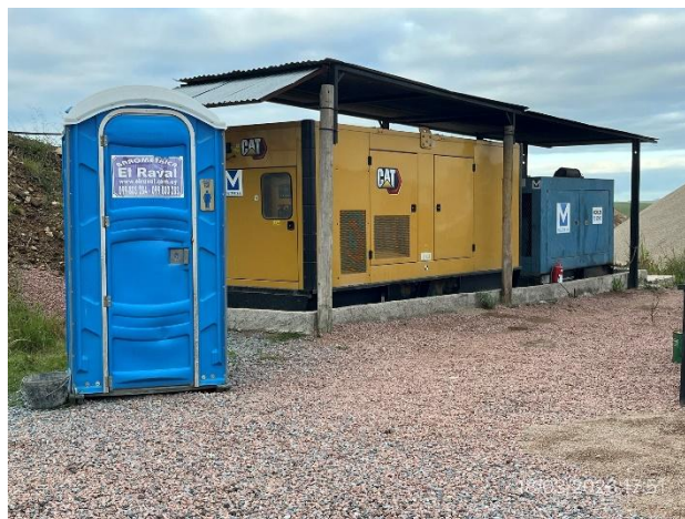
Foto 12.2-8, P03. Planta asfáltica, generadores eléctricos bajo techo y con envallado impermeable.
