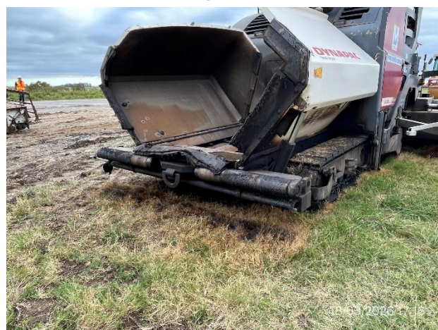
Foto 12.1-12, P01. Hay derrames de emulsión asfáltica sobre el terreno natural.
