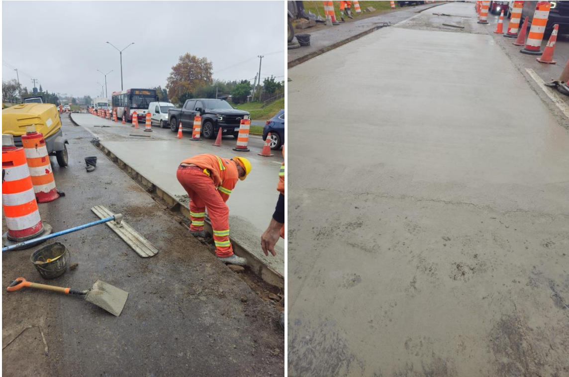
Bacheo de hormigón (R8 km 18) - Registro fotográfico realizado por personal de Colier 05/2026.
