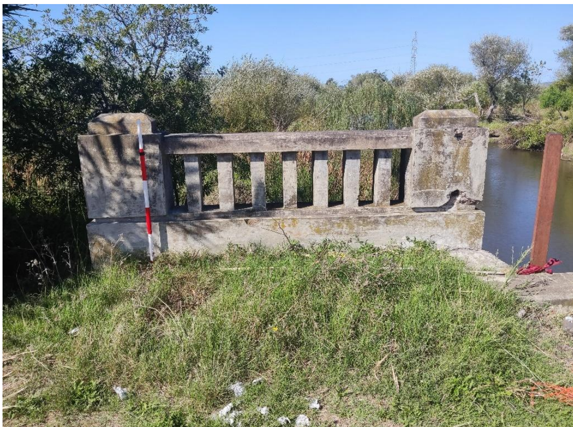
Figura 3-4: Puente en arroyo El Renegado, previo a su demolición. 13 de marzo de 2023.
