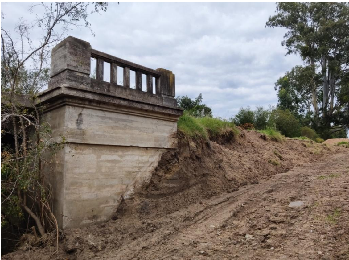
Figura 3-18: Vista externa de columna de entrada al puente viejo en arroyo El Canelón, progresiva 191.800. 11 de abril de 2023.
