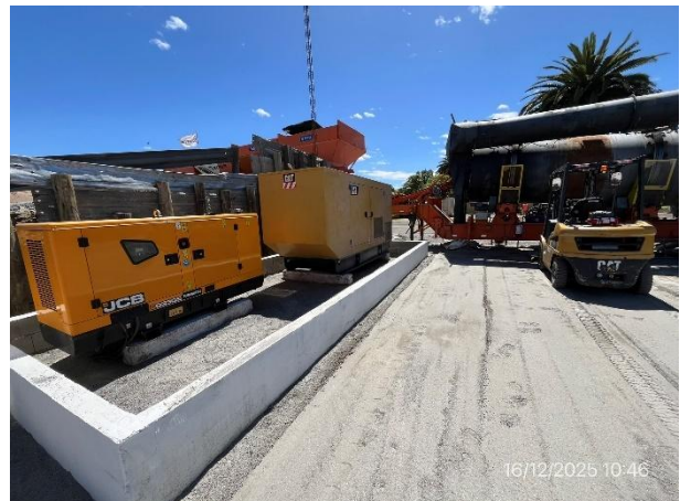
Foto 12.2-4, P03. Planta asfáltica, recinto correctamente envallado para alojar generadores eléctricos.
