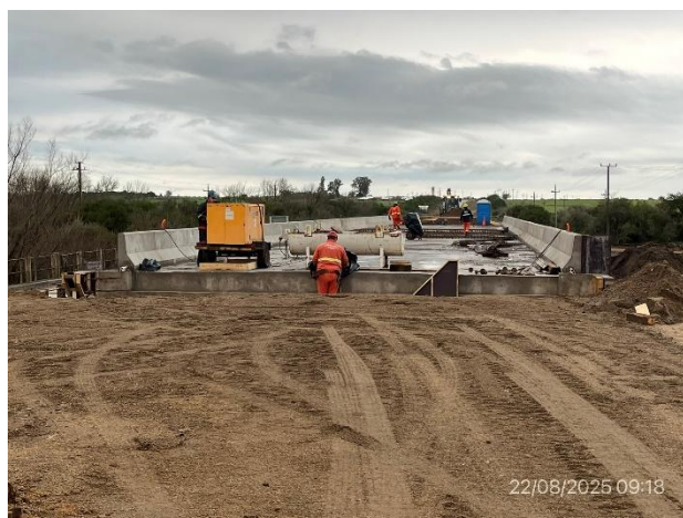
Foto 12.2-16, P02. En el tablero superior la cuadrilla de trabajo no tiene a disposición infraestructura para acopio de residuos segregados en origen.
