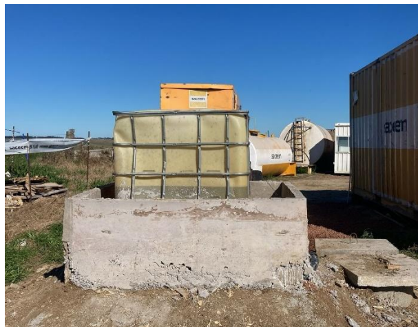
Foto 12.4-1, P05. Planta de hormigón. Se aumentó el volumen del envallado perimetral donde se aloja la tarrina de gasoil.
