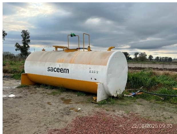
Foto 12.1-4, P05. Tanque de agua no potable.
