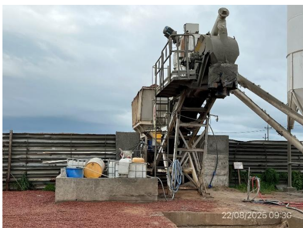
Foto 12.1-5, P05. Tanques de productos químicos alojados en sector con envallado perimetral
