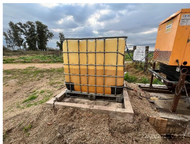
Foto 12.1-6, P05. Tanque de gasoil, el envallado perimetral no cubre el 110% del volumen alojado.
