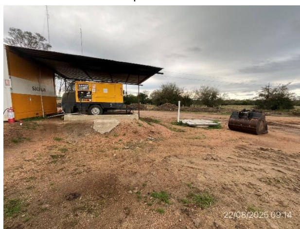
Foto 12.2-12, P02. Obrador SACEEM, reservorio impermeable para aguas servidas.
