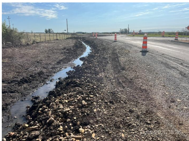
Foto 12.1-5, P01. Rotonda terminada, sector con drenajes inadecuados, falta culminar el perfilado.
