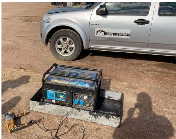
Foto 12.2-3, P03. Se colocó el generador eléctrico sobre una bandeja estanca.
