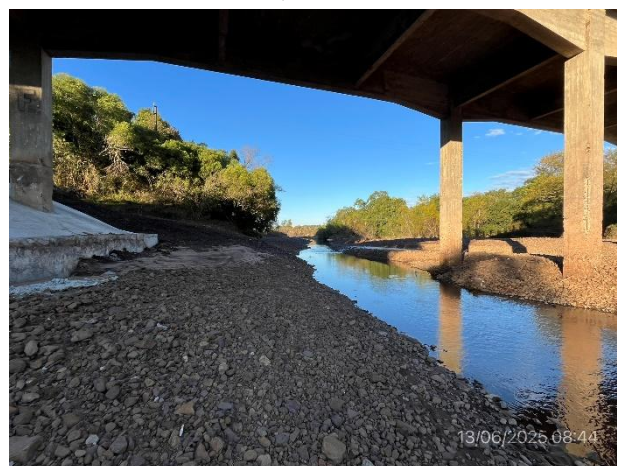
Foto 12.1-6, P01. Patologías en pilares. Hierros expuestos y oquedades en hormigón existente.
