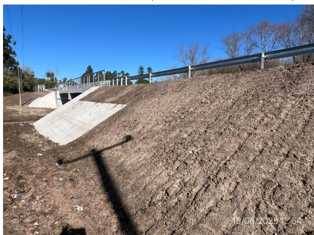
Foto 12.1-5, P01. Terraplén norte de la senda a (+), no hay cobertura vegetal.
