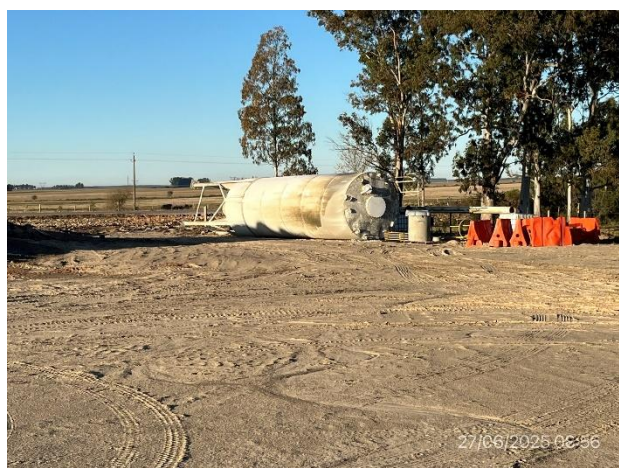
Foto 12.1-6, P03. Componentes de planta de hormigón pendientes de ser retirados
