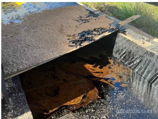
Foto 12.2-11. P03. Obrador. Digestor de aguas oleosas.
