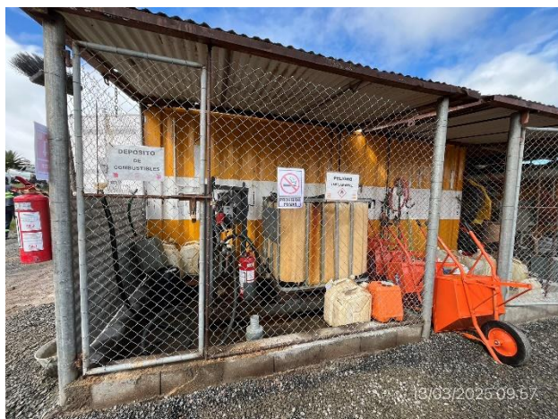
Foto 12.1-23, P03. Campamento principal. Recinto envallado y techado para alojar surtidor de combustible.
