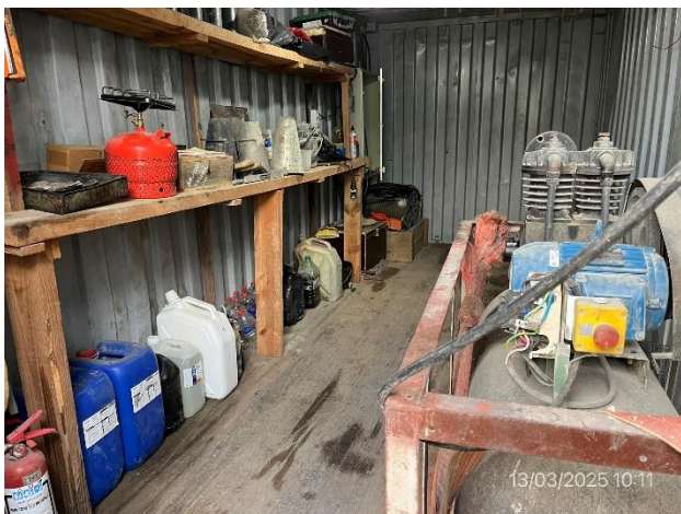
Foto 12.2-3, P04. Pañol, se encuentran bidones y botellas sin rótulo que contienen hidrocarburos. No hay elementos para contención de eventuales derrames.
