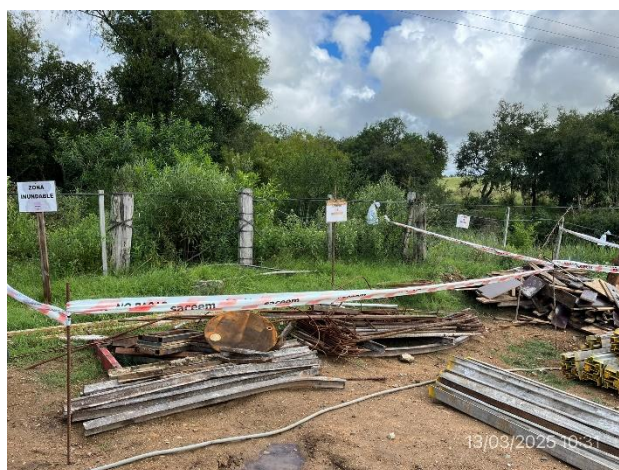
Foto 12.1-12, P02. Equipamiento de obra estibado en zona inundable
