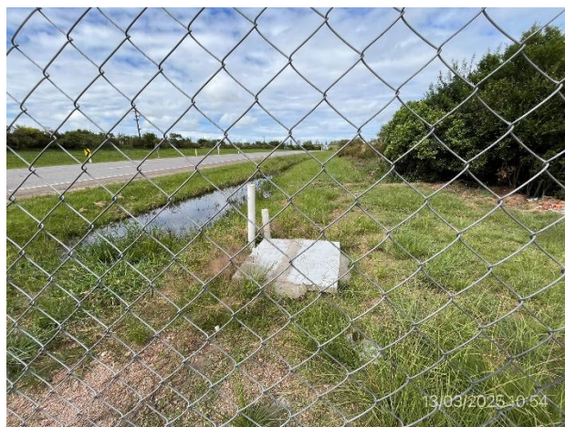
Foto 12.1-8, P01. Depósito impermeable de aguas servidas.
