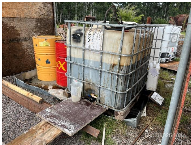
Foto 12.2-4, P04. El sector previsto para almacenar productos químicos tiene un envallado perimetral estanco con capacidad insuficiente de almacenaje.
