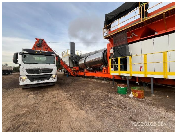
Foto 12.2-2, P03. Planta asfáltica, buenas condiciones de orden y limpieza.
