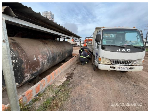
Foto 12.2-9, P03. Cisterna de combustible en recinto envallado. La maniobra de recarga de combustible se realiza sin el apoyo de bandejas impermeables
