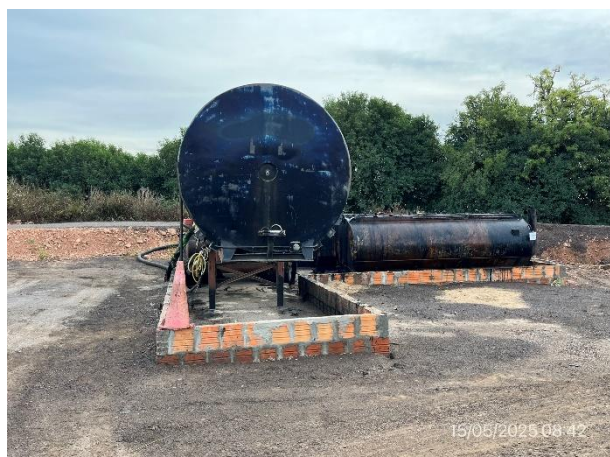
Foto 12.2-5, P03. Planta asfáltica, cisternas de emulsión con envallados perimetrales correctos.
