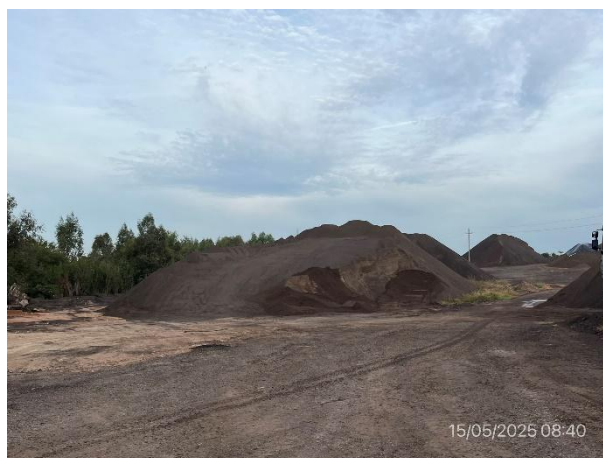
Foto 12.2-4, P03. Planta asfáltica, explanada para maniobras y acopio de áridos.
