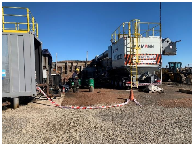
Foto 12.1-3, P04. Planta asfáltica sin actividad. No cuenta con envallado para prevención de derrames.
