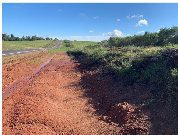
Foto 12.2-4. P07, Ruta 27 progresiva 81K000 a (-). Faja pública con pendientes pronunciada y evidencias de erosión.
