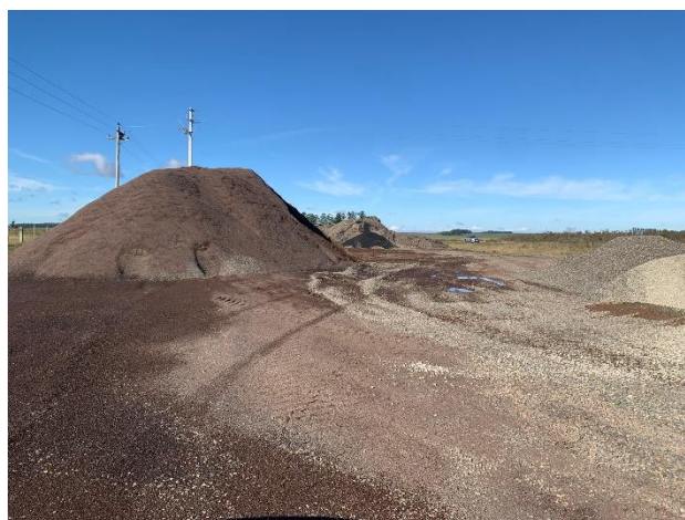
Foto 12.1-8, P04. Obrador, acopio de áridos permanecen en el predio.
