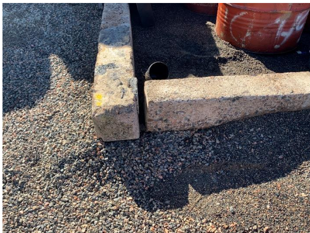
Foto 12.1-5, P04. Obrador, el envallado no cumple su función al estar perforado.
