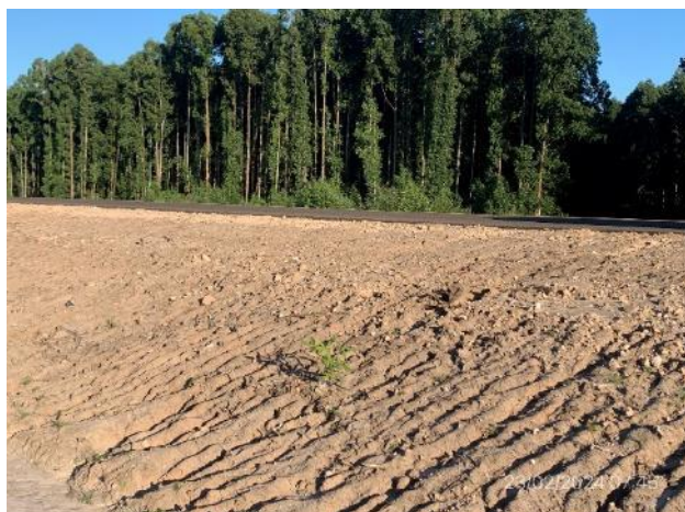
Foto 12.2-3, Ruta 20. Tramo de talud erosionado. No hay cobertura vegetal.
