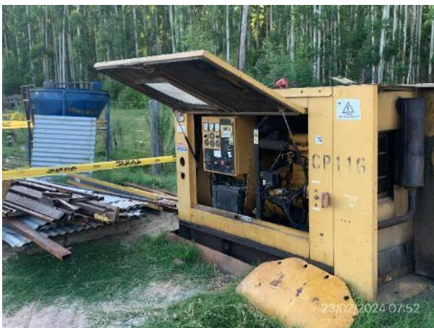
Foto 12.2-9, P03. Obrero secundario, generador eléctrico alojado dentro de recinto impermeable
