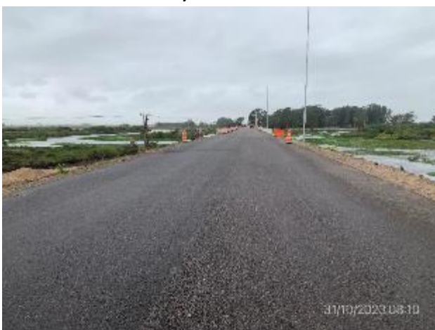
Foto 12.2-5. Carpeta asfáltica ejecutada en ensanche y readecuación de accesos a ambos puentes.
