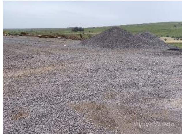
Foto 12.1-8, P06. Planta asfáltica, padrón rural nº33808 de la 5ª SC de Rocha. Plataforma de acopio de áridos.
