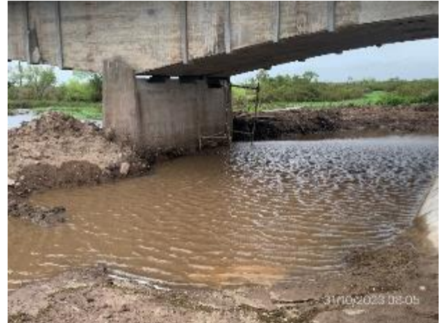
Foto 12.2-2, P02. Puente secundario. Ataguías pendientes de ser removidas. Curso de agua limpio.
