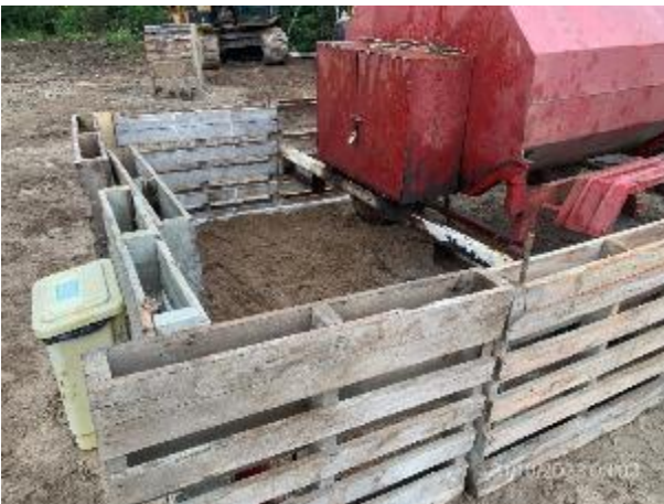
Foto 12.1-3. P05. Obrador. tanque móvil de combustible alojado en recinto envallado e impermeabilizado.
