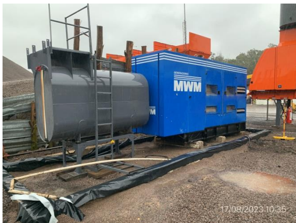
Foto 12.3-5 Grupo electrógeno con vallado perimetral estanco.
