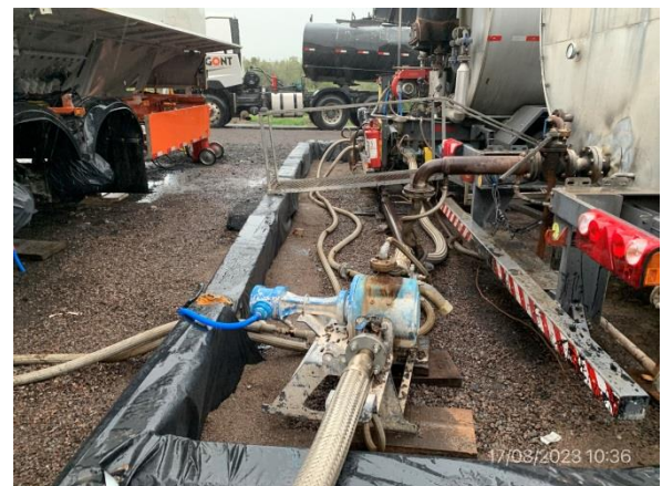
Foto 12.3-6 planta asfáltica con vallado perimetral estanco.
