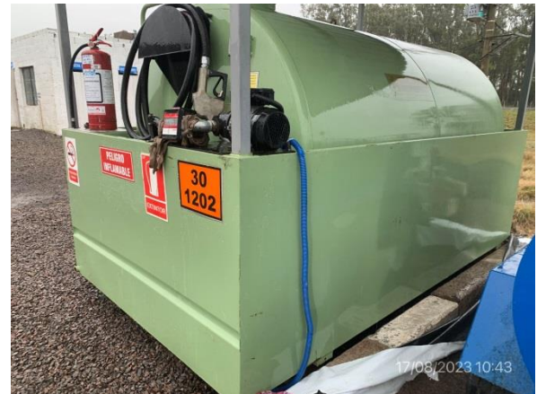
Foto 12.3-4 Tanque de combustible con vallado metálico impermeable.
