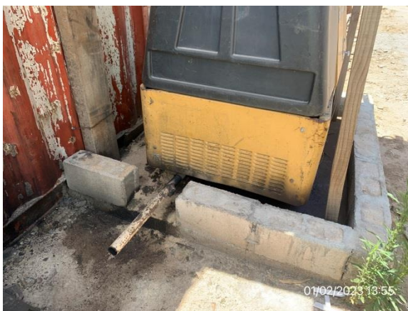
Ilustración 26 – P03, Obrador. Grupo electrógeno con envallado perimetral perforado.
