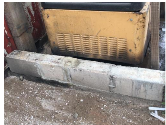
Ilustración 27 – P03, Obrador. Grupo electrógeno con envallado perimetral reparado. Fotografía proporcionada por la empresa el 02/02/2023.
