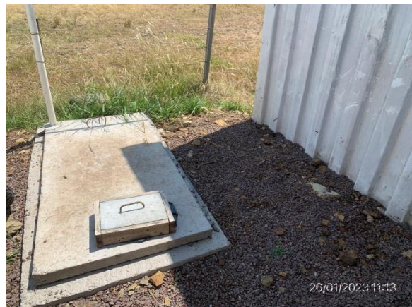
Ilustración 9 – P01, Obrador principal. Depósito impermeable de aguas servidas.
