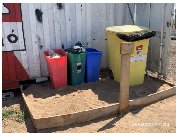
Ilustración 10 – P01, Obrador principal. Estación de acopio de residuos segregados por corriente de generación.
