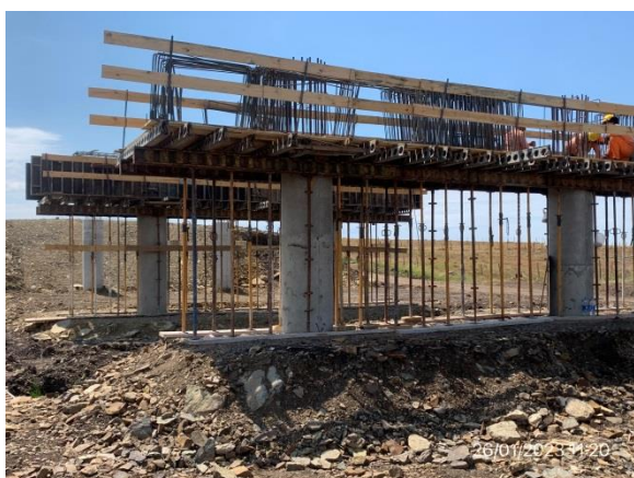
Ilustración 18 – P01, Puente sobre A° Tala en ejecución. No hay infraestructura para gestión de residuos de forma segregada.
