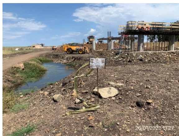
Ilustración 19 – P01, Puente sobre A° Tala en ejecución. Demarcación de máxima creciente correcta.
