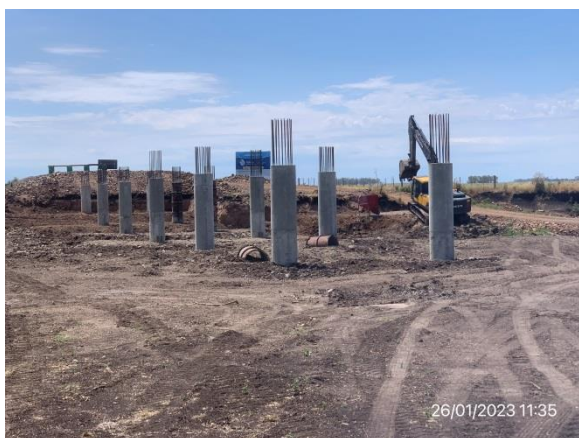
Ilustración 22 – P02, Puente sobre A° Rolón en ejecución. No hay infraestructura para gestión de residuos de forma segregada ni servicios higiénicos para el personal.
