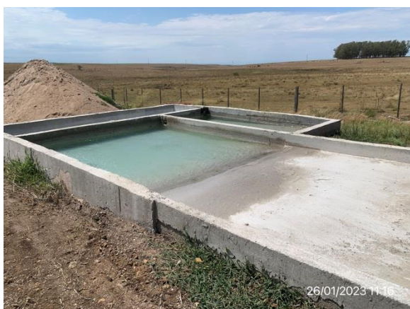
Ilustración 12 – P01, Obrador principal. Pileta de decantación de aguas de lavado de camiones mixer.
