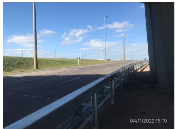
Ilustración 15 – P10, Obra terminada, Av. Millán, puente sobre Ruta 5 progresiva 10K800. Zona limpia y restaurada.
