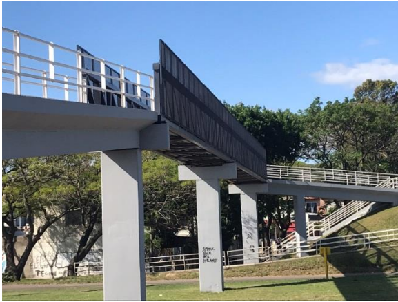
Ilustración 10 – P06, Obra terminada, puente peatonal sobre Accesos a Montevideo, progresiva 4K200. Puente en funcionamiento, abierto al paso peatonal.
