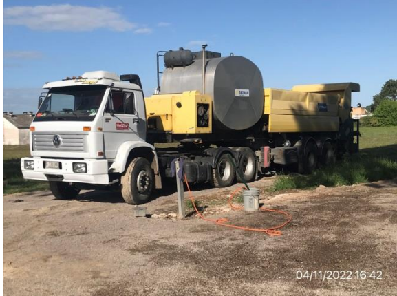
Ilustración 4 – P03, Obrador. Equipo para riego bituminoso en banquetas.
