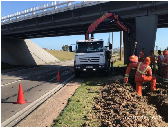
Ilustración 16 – P09, Frente de obra, Av. Luis Batlle Berres, puente sobre Ruta 5 progresiva 8K400. Subcontratista Bordonix con tareas en ejecución.
