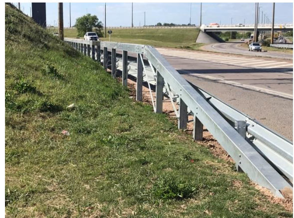
Ilustración 13 – P07, Obra terminada, intercambiador Rutas 1 y 5. Ruta 1 progresiva 6K500. Tapiz vegetal recompuesto.
