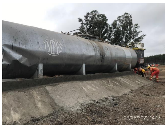
Ilustración 13 – P03, Obrador. Depósito de emulsiones asfálticas con envallado perimetral.
