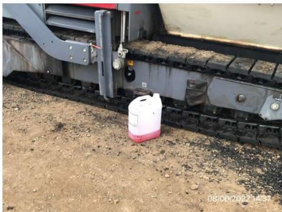
Ilustración 10 – P02, Fin de tramo. Mantenimiento mecánico liviano sin implementos de contención de derrames.
