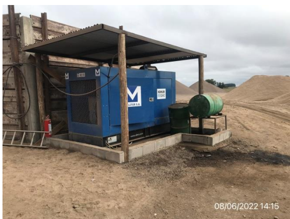
Ilustración 12 – P03, Obrador. Planta asfáltica. Generador eléctrico techado y con envallado perimetral.
