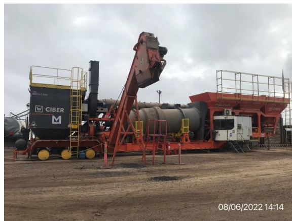
Ilustración 11 – P03, Planta asfáltica con filtro de mangas.
