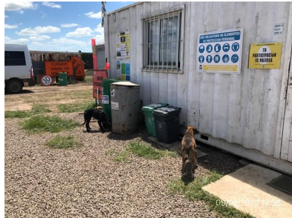
Ilustración 17 – P03, Obrador. Estación de acopio de residuos segregados por corriente de generación. Resulta escasa dado el porte del obrador.
