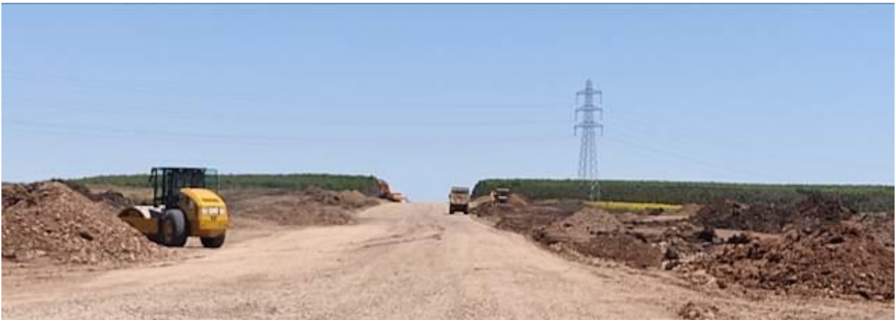
Foto 13.2-2 Cruce de líneas de servicio eléctrico.
