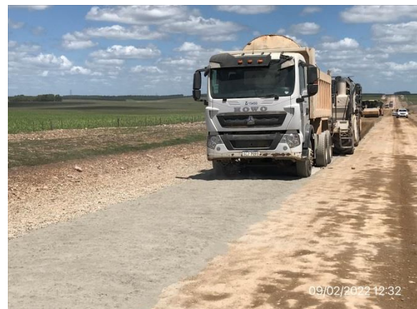
Ilustración 7 – P04, Frente de obra. Trabajos de cementado de base granular en ejecución.
