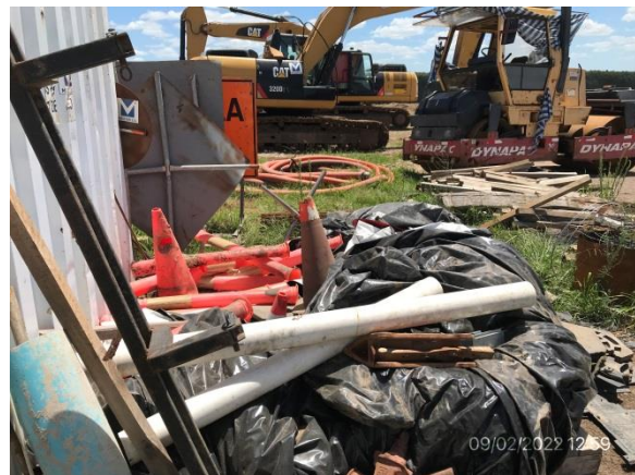
Ilustración 19 – P03, Obrador. Insumos y residuos mal dispuestos por falta de infraestructura.
