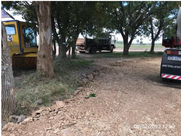
Ilustración 10 – P05, Campamento provisorio. No hay infraestructura de confort para personal ni para gestión segregada de residuos.
