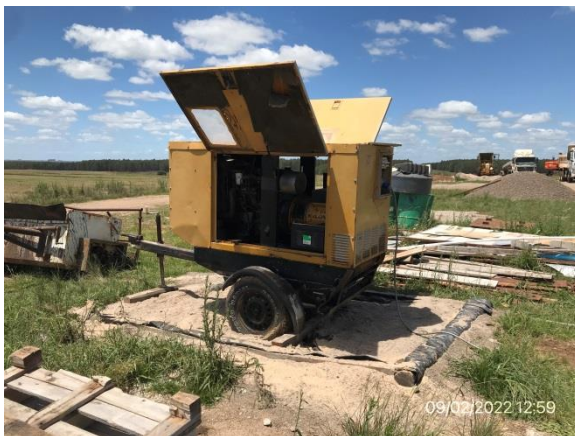
Ilustración 18 – P03, Obrador. Generador eléctrico estacionado en sector con envallado impermeable.
