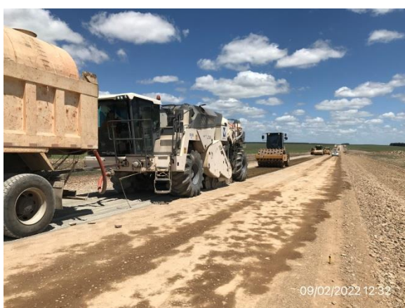
Ilustración 8 – P04, Frente de obra. Trabajos de cementado de base granular en ejecución.
