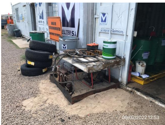
Ilustración 14 – P03, Obrador. Moto generador instalado sobre bandeja impermeable.
