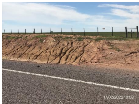
Ilustración 9 – Obras terminadas en Camino a la Balsa. Taludes erosionados en faja pública, lado a (-).
