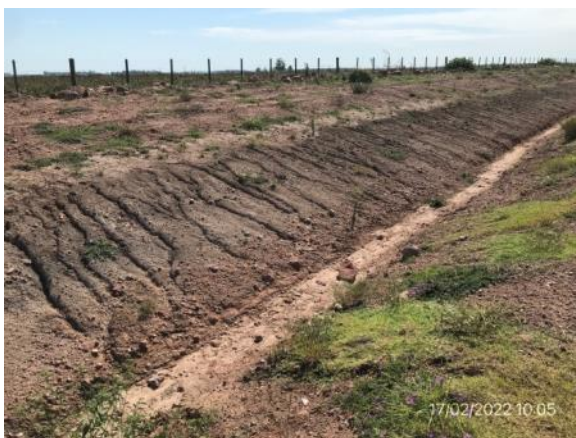
Ilustración 8 – Obras terminadas en Camino a la Balsa. Taludes erosionados en faja pública, lado a (-).
