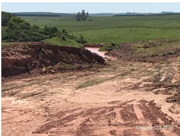
Ilustración 14 – P03, Cantera padrón N°9942 de Durazno. Tareas extractivas culminadas y laguna de decantación operativa.
