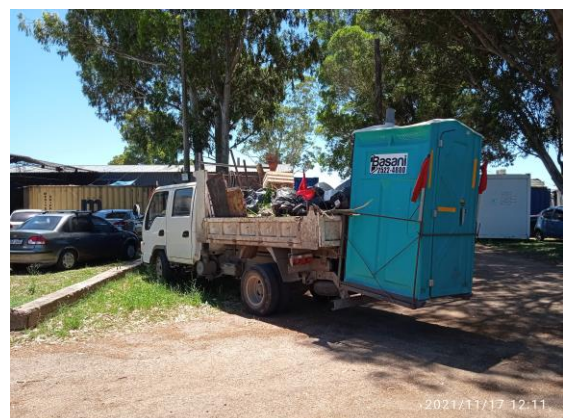
Ilustración 15 – P03, Obrador. Camión que transporta cuadrilla y baño químico a frente de obra.
