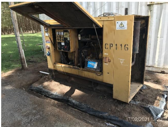
Ilustración 8 – P03 – Obrador. Generador con envallado perimetral.
