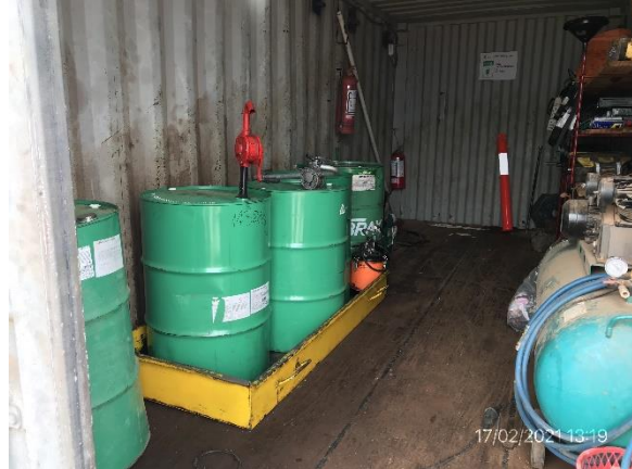
Ilustración 5 – P03 – Obrador. Contenedor con lubricantes alojados sobre bandejas estancas para prevenir derrames durante trasiegos.
