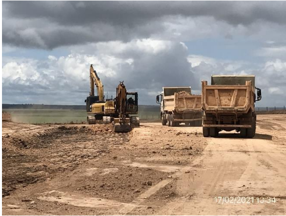
Ilustración 16 – P07 – Frente de obras en nueva traza del Camino a la Balsa.
