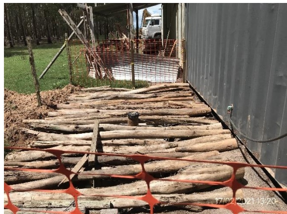
Ilustración 9 – P03 – Obrador. Depósito impermeable para efluentes domésticos.
