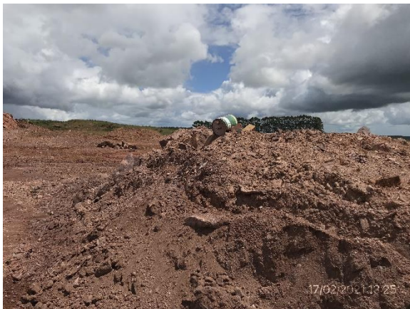
Ilustración 12 – P03 – Cantera. Residuos sin correcta disposición.
