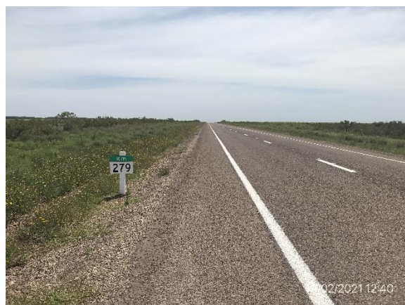
Ilustración 7 – Trabajos terminados en Ruta 4, con tapiz vegetal en expansión en zona de banquinas.
