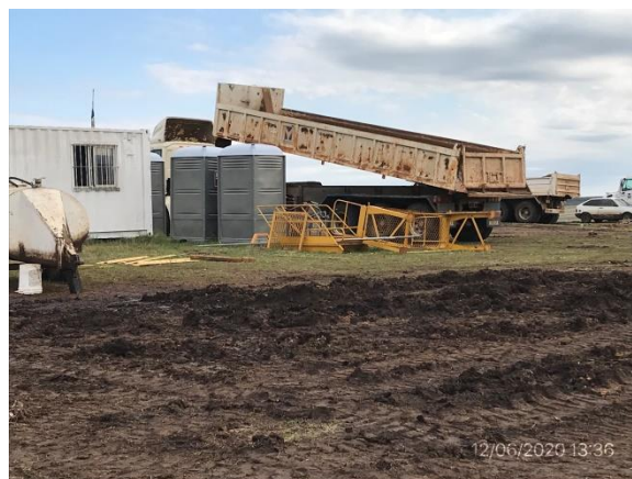
Ilustración 17 – P03. Obrador. Baños químicos.
