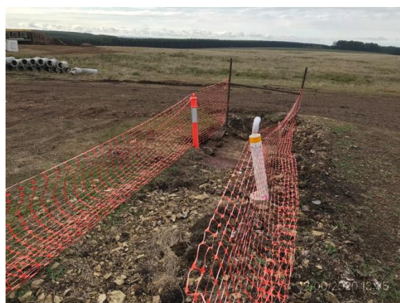
Ilustración 15 – P03 Obrador. Depósito impermeable para servicios higiénicos.
