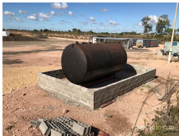
Ilustración 11 – P06. Obrador central de Gofinal S.A tanque de combustible con vallado perimetral.
